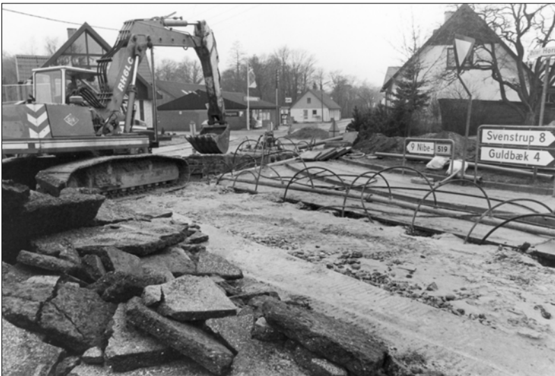
For at holde udgravningerne fri for vand blev der pumpet enorme vandmængder ud i bækken
